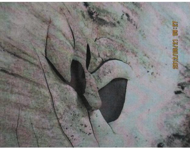
涂层与基底脱落
