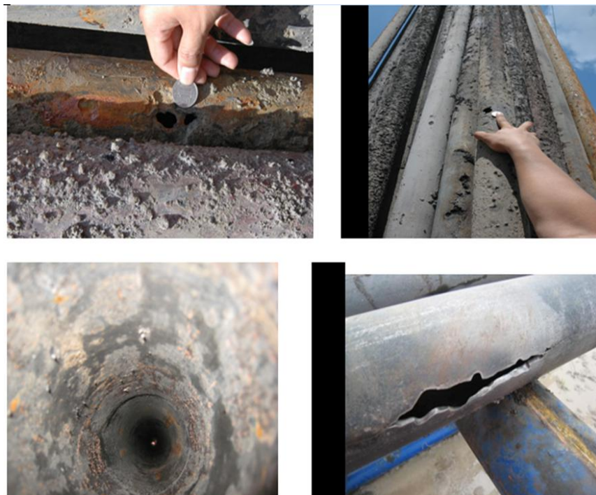
13Cr油管氯化盐（钠、钾、钙）腐蚀及应力腐蚀开裂
